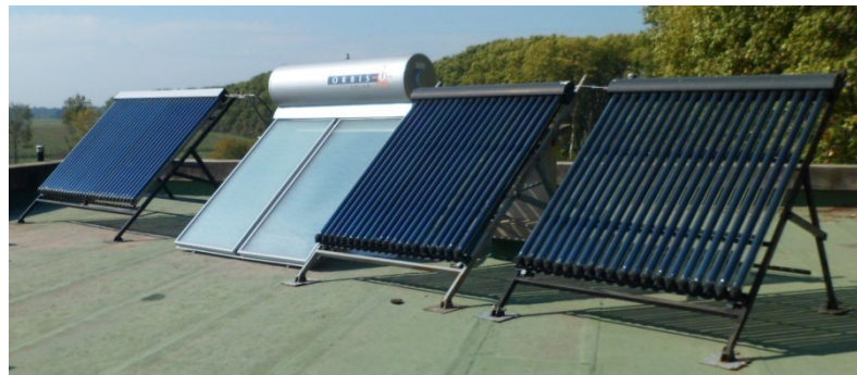
Figura 8. Cuatro colectores solares que se utilizan para calentar agua sanitaria. Como se aprecia estos cuatro sistemas son de dos tecnologías diferentes: placa plana con cubierta (segundo de la izquierda) y tubos de vacío el resto. [10]
